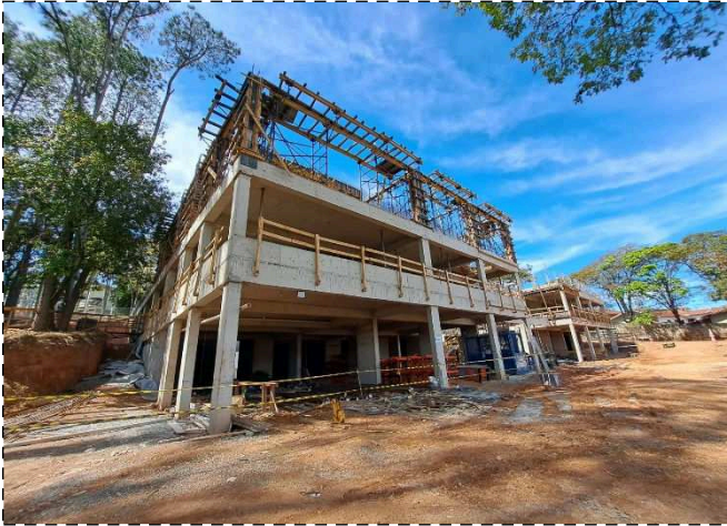
FOTO 1 – Laje garagem G1
