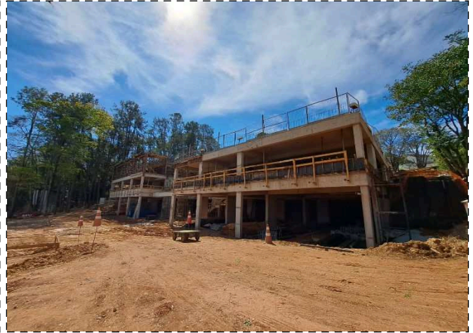
FOTO 2 – Laje garagem G1
