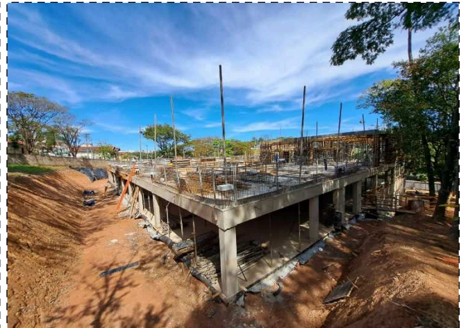
FOTO 4 – Laje garagem G1
