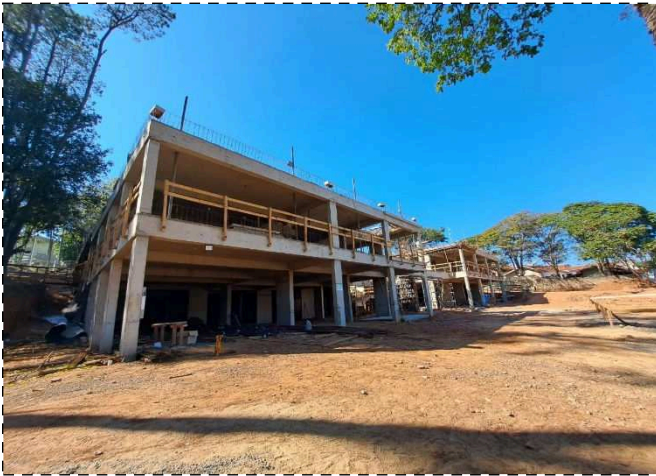
FOTO 1 – Laje garagem G2
