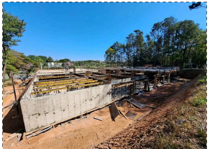
FOTO 4 – Laje garagem G2
