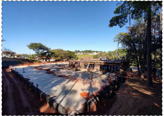
FOTO 2 – Laje garagem G2
