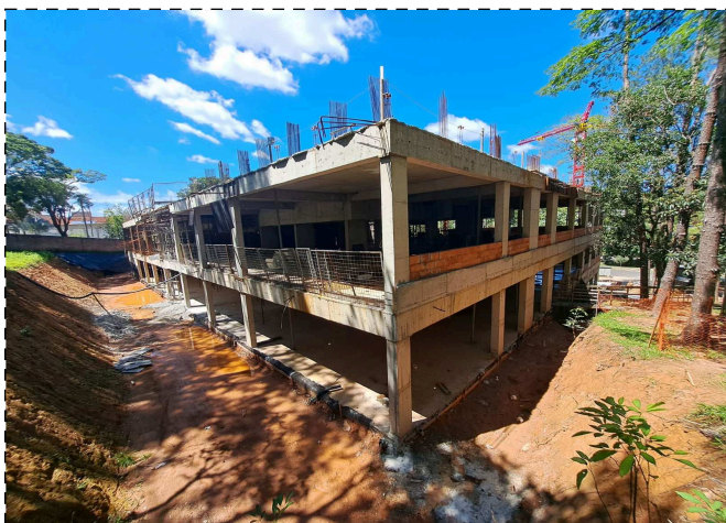
FOTO 3 – Laje garagem G1
