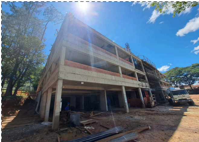
FOTO 1 – Laje garagem G1
