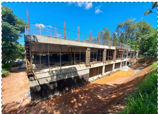
FOTO 4 – Laje garagem G1
