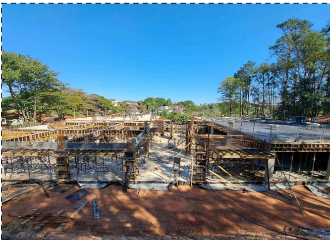
FOTO 3 – Laje garagem G2
