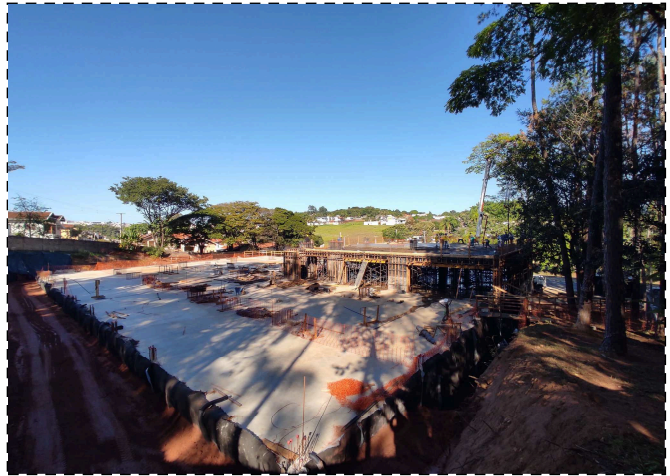
FOTO 2 – Laje garagem G2
