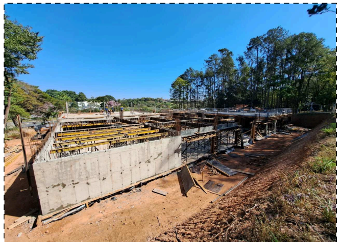
FOTO 4 – Laje garagem G2
