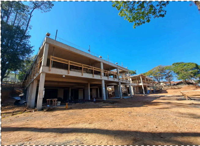
FOTO 1 – Laje garagem G2
