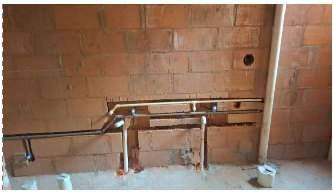
FOTO 4 – Distribuição de esgoto e água fria dos banheiros do 1º pavimento.
